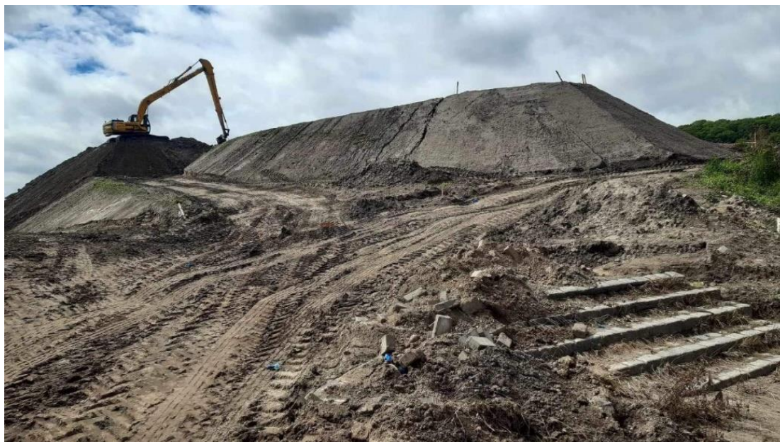
Rycina 2. Bastion św. Gertrudy w trakcie prac rewitalizacyjnych – prowadzone prace ziemne polegające na formowaniu przez sprzęt budowlany zboczy bastionu (fot. M. Książek; 07.2023).
